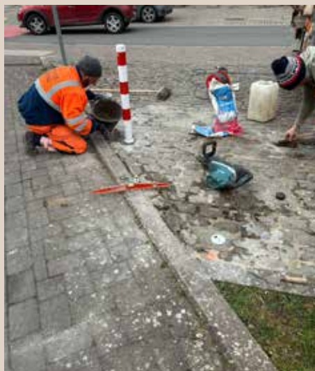
Installation de bollards pour placer des fourreaux lors des festivités, ici au monument de Villers-Poterie.
