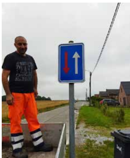
Remise en état de signalisation endommagée par le passage d'engins agricoles rue de Presles.
