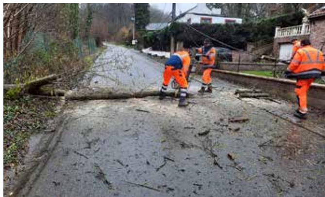
Dégagement d'un arbre tombé sur la voirie Petit Floreffe
